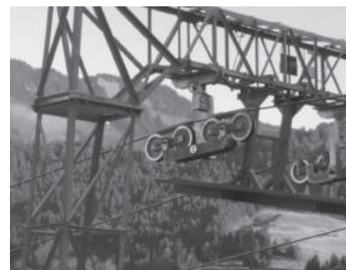
Lift Rollenbatterie auf Stütze
